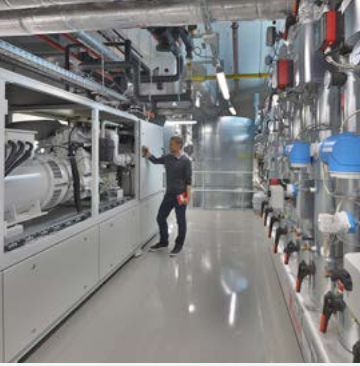
Blockheizkraftwerk und Warmwasserspeicher im Keller des Fraunhofer IISB. © Kurt Fuchs / Fraunhofer IISB
